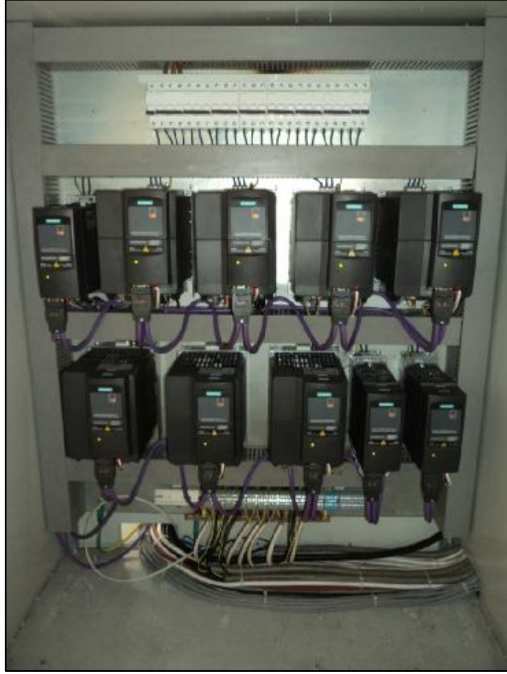
Şekil 4.31. Makinenin AC motor hız kontrol üniteleri
